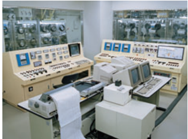
中央コントロール室
