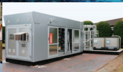
加熱強制循環洗浄装置を当社本社屋外作業場にて検査中
